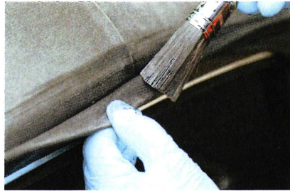
An die Ecken denken: Ist das Dach erst imprägniert, ist es zu spät, vergessene Stellen nachzubessern
